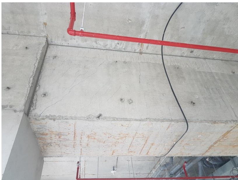
Hình 1: Nứt bề mặt dầm chuyển tại một công trình ở Hà nội
